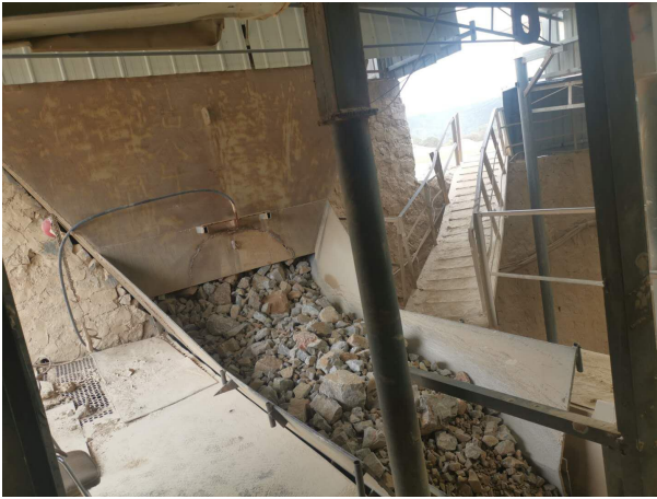
技改项目新增破碎机
