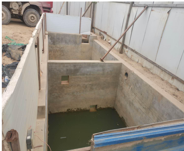
项目东南角初期雨水收集池 (120m 3 )
