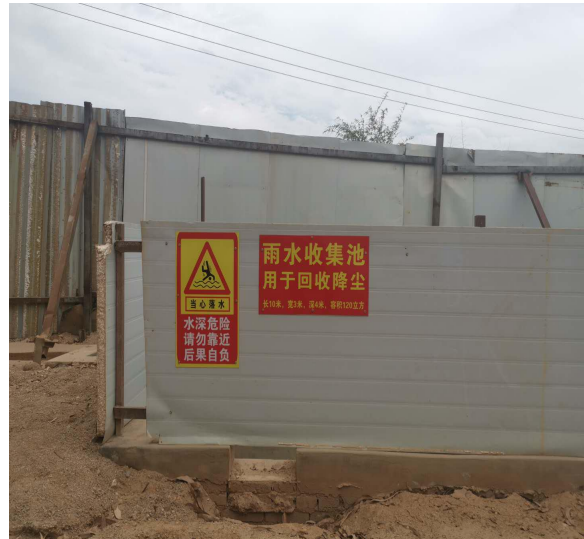
项目东南角初期雨水收集池 (120m 3 )
