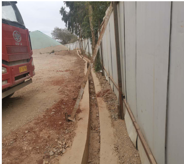
项目东南角截排水沟
