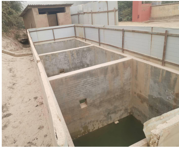
厂区门口初期雨水收集池（120m 3 ）
