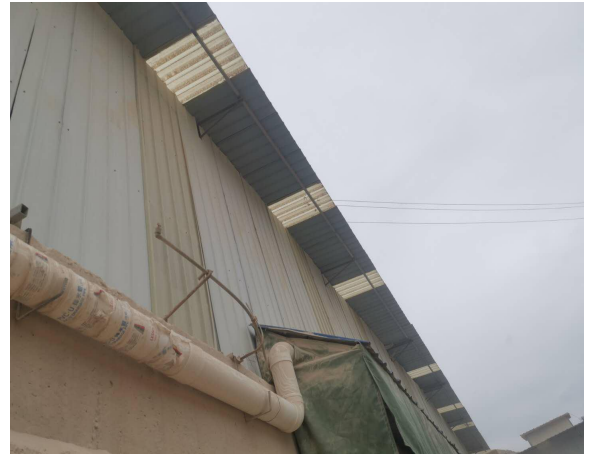
粉尘收集管道
