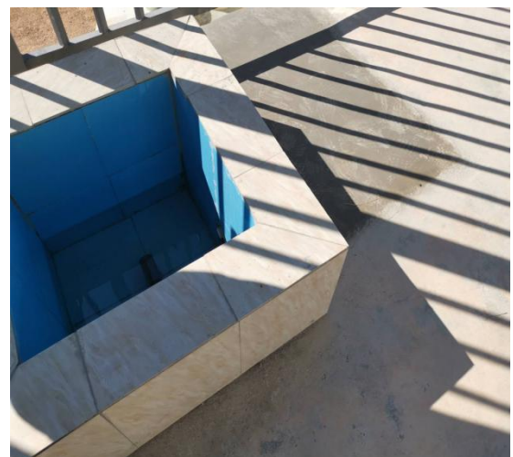
渗滤液处理站废水排放口
