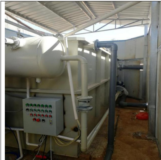
污水处理站——操作室
