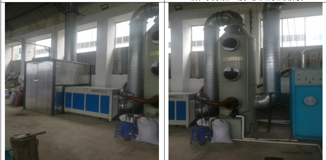
项目“集气+喷淋+低温等离子体+光氧催化+活性炭吸附”废气处理设施
