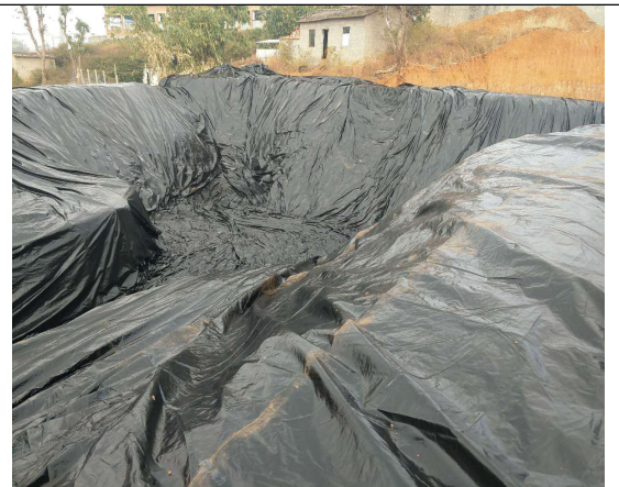
项目事故水池
