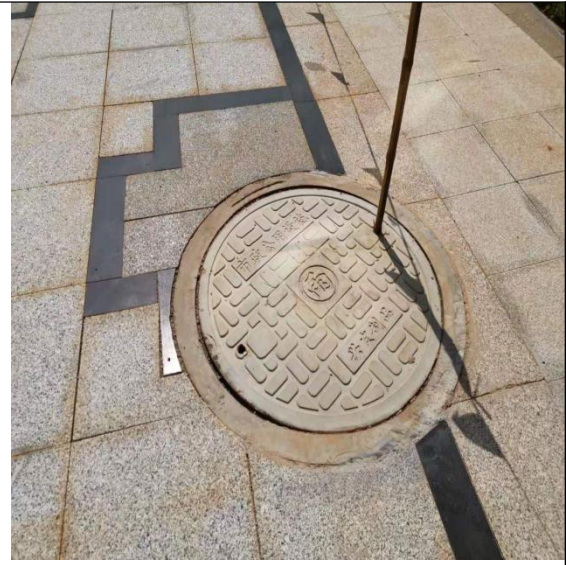
项目（A2 地块）雨水总排口
