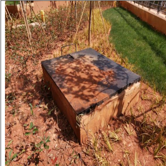
项目（A2 地块）雨水收集池
