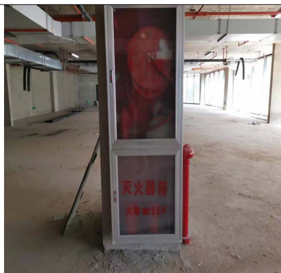
项目 (A3 地块) 消防器材
