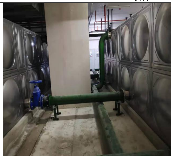
项目 (A3 地块) 地下室水泵房
